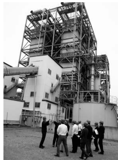
燃料供給設備
