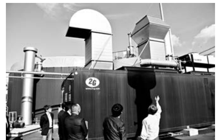
発電機・CHPユニット
