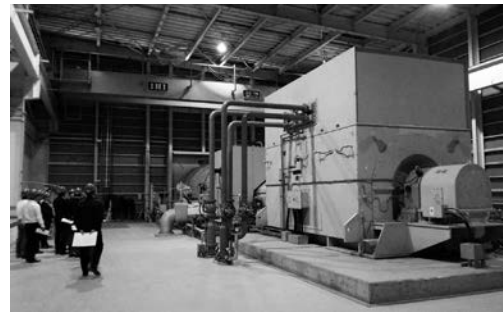
蒸気タービン・発電機
