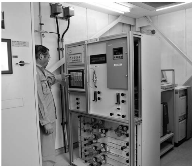
都市ガス計測装置
