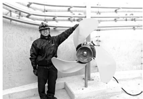
加温配管と攪拌機（発酵槽内部）
