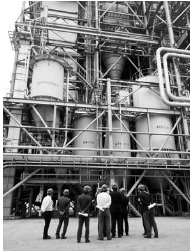
ボイラー設備
