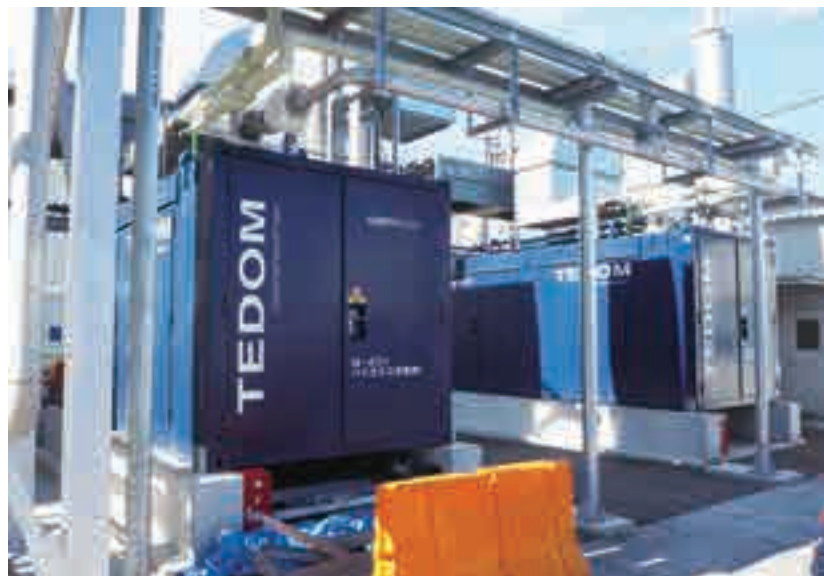
バイオガス発電設備
