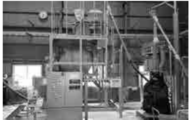
混合攪拌機 (⑦)
