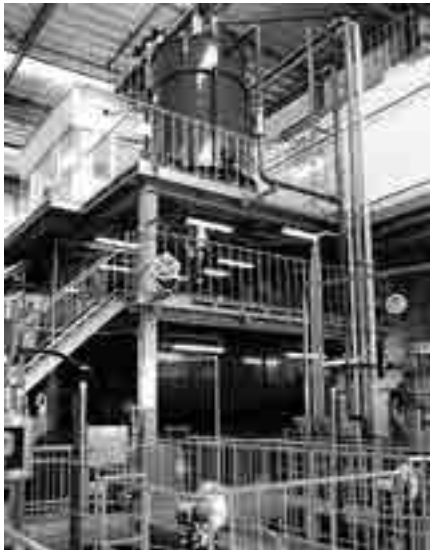
RFプラント全景
