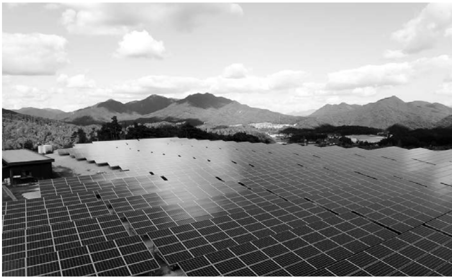
最終処分場の跡地に設置した太陽光パネル
