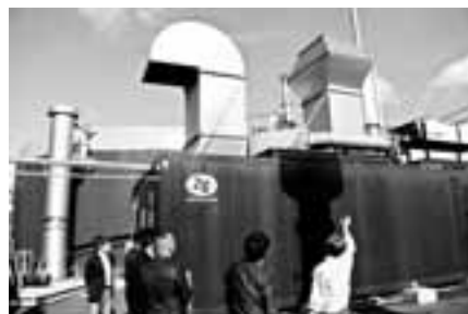
発電機・CHPユニット
