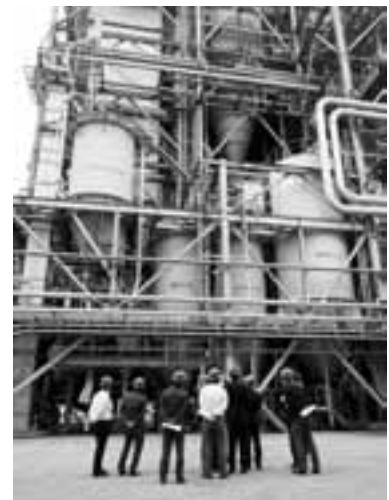
ボイラー設備
