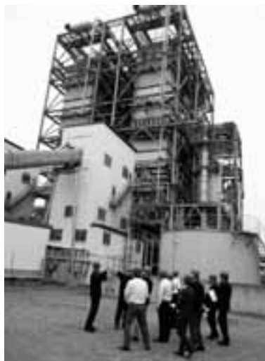
燃料供給設備
