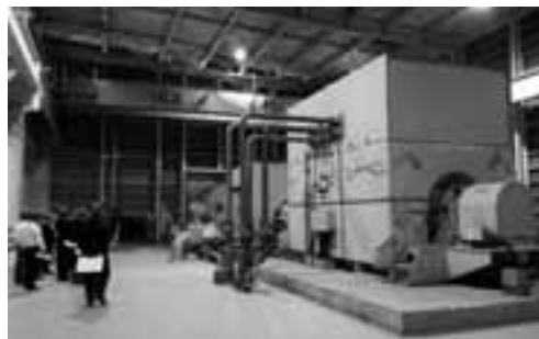
蒸気タービン・発電機
