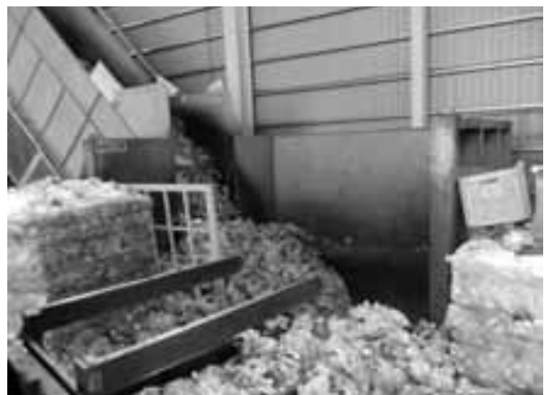
PETボトルのプラントの投入口
