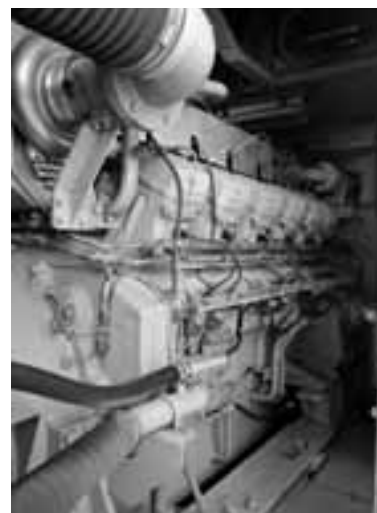
ガスエンジン発電機
