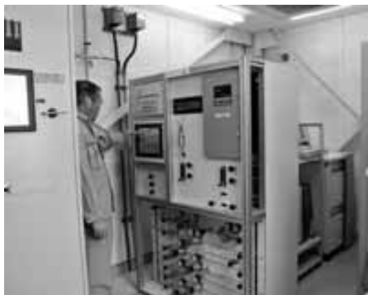
都市ガス計測装置
