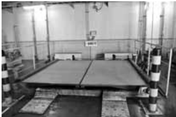
投入ピットテーブル
