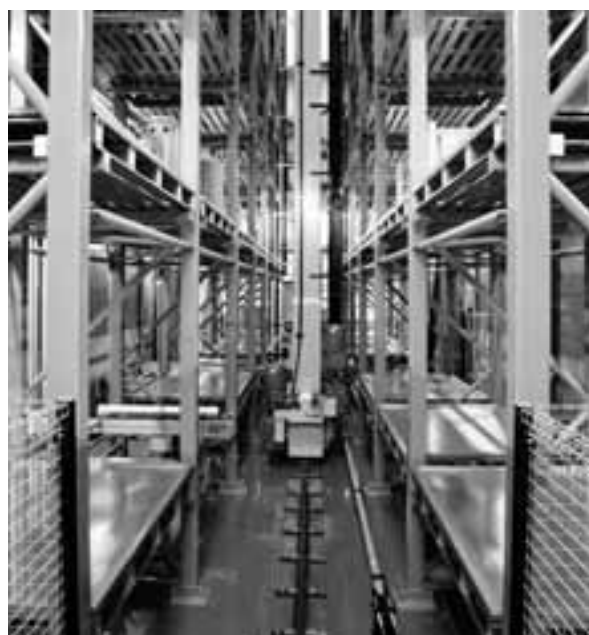
受入保管立体倉庫
