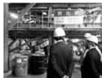
下水汚泥炭化施設の投入口(上)、監視室(中)、炭化炉前面(下)
