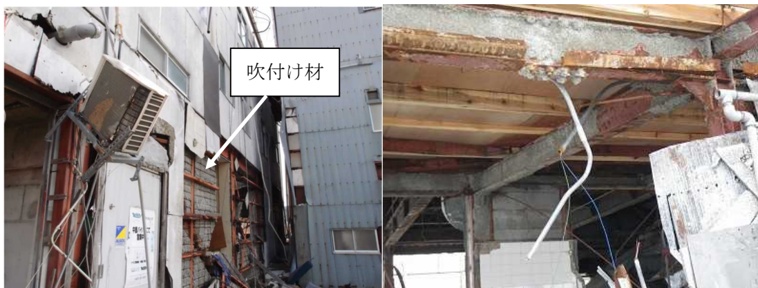
吹付け材が露出している例
