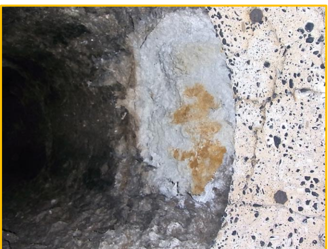
④煙突用石綿断熱材
