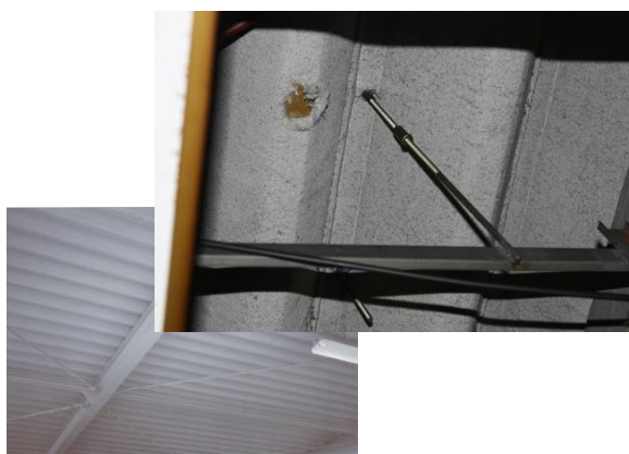
②石綿含有断熱材等:屋根用折板石綿断熱材
