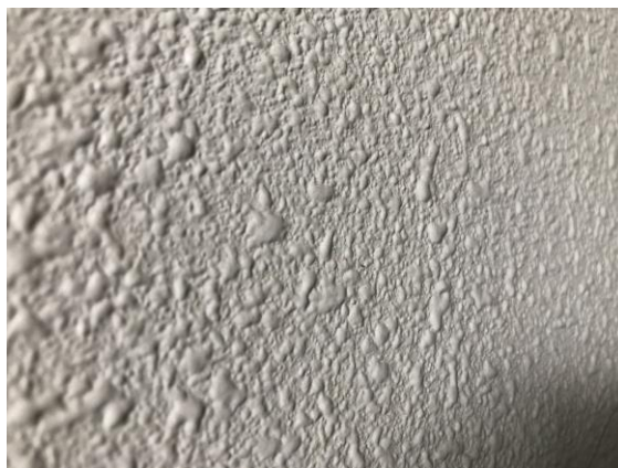
④石綿含有仕上塗材:吹付けタイル
