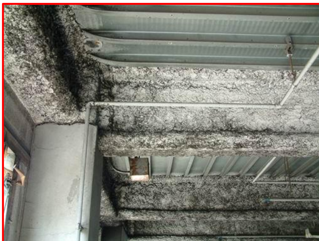
②石綿含有吹付けロックウール
