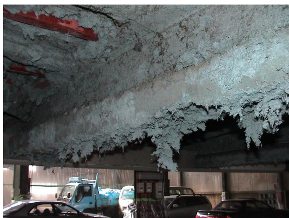
①石綿含有吹付け材:吹付け石綿(クロシドライト)
