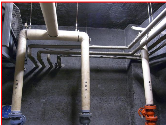
①吹付け石綿(クロシドライト)
