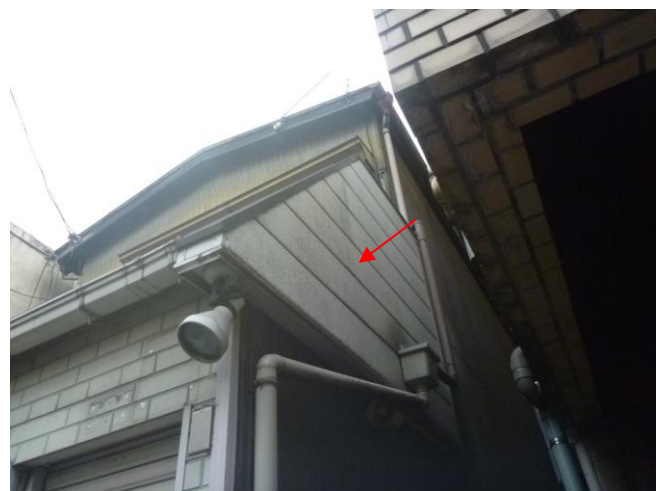
⑥石綿含有窯業系サイディング
