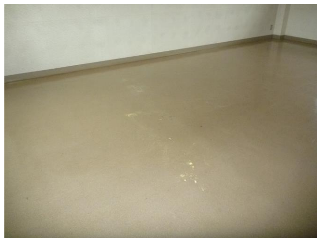
⑤石綿含有ビニル床シート
