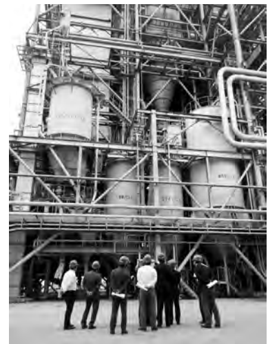
ボイラー設備
