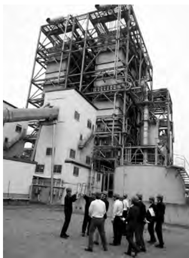
燃料供給設備
