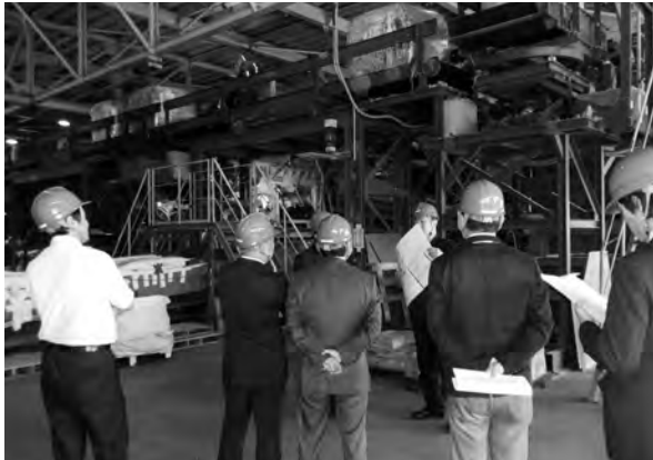
自動投入設備
