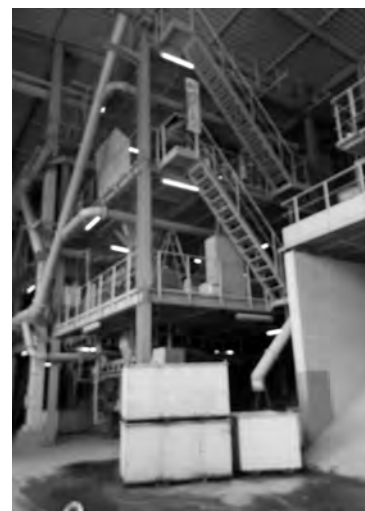
ガラスカレットプラント
